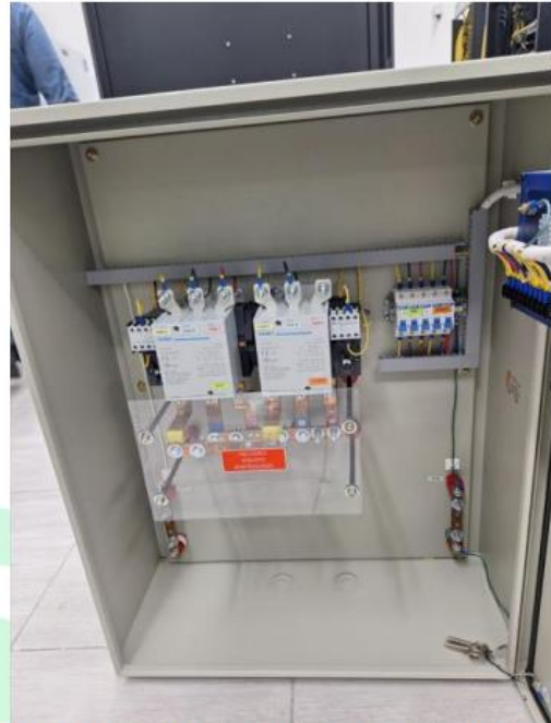
Imagen 3: Transferencia automática nueva
