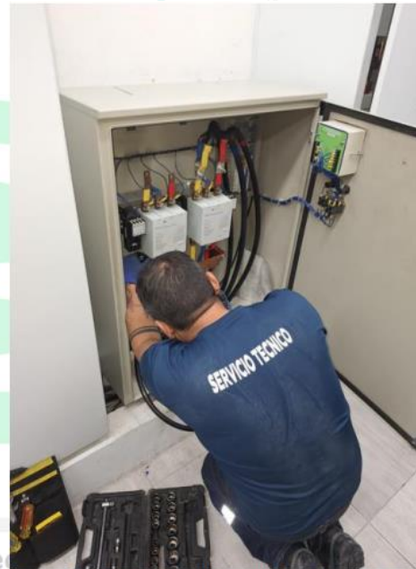
Imagen 7: Marcación de cableado desconectado
